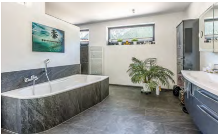
Geräumiges Bad: Das Sanitäre und die Heizung stammen von der Firma Hartwig Gstrein GmbH.
