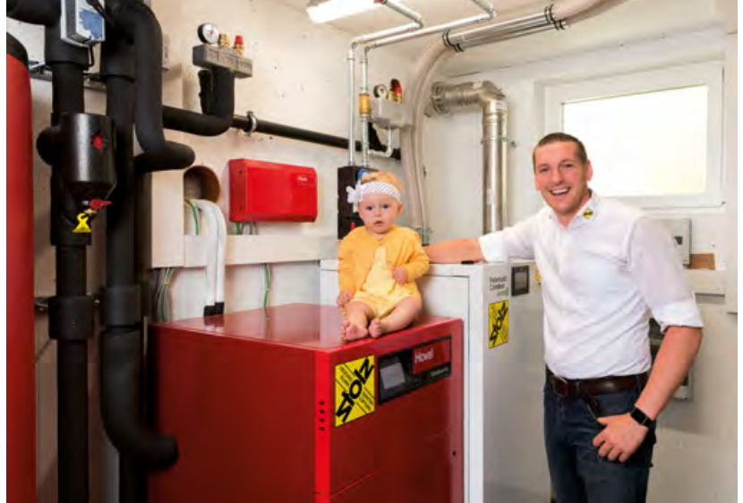
Modernste Haustechnik der Firma Stolz: Der Bauherr Lukas Ginther steht immer gerne für Auskünfte über dieses Thema zur Verfügung (Tel. 0664 6125109).
